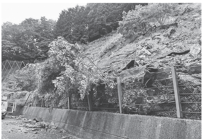
国道309号上北山村西原の崩土現場
