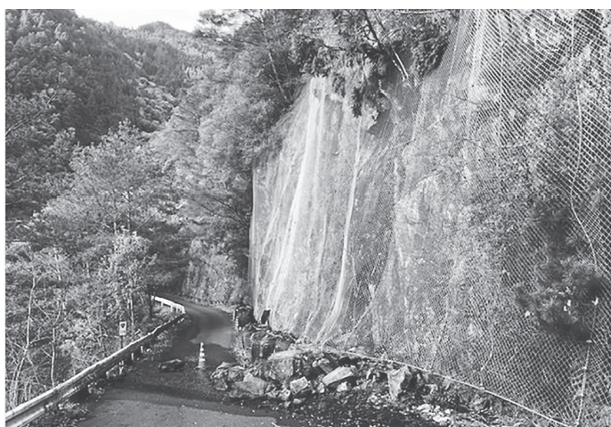
崩土現場状況
