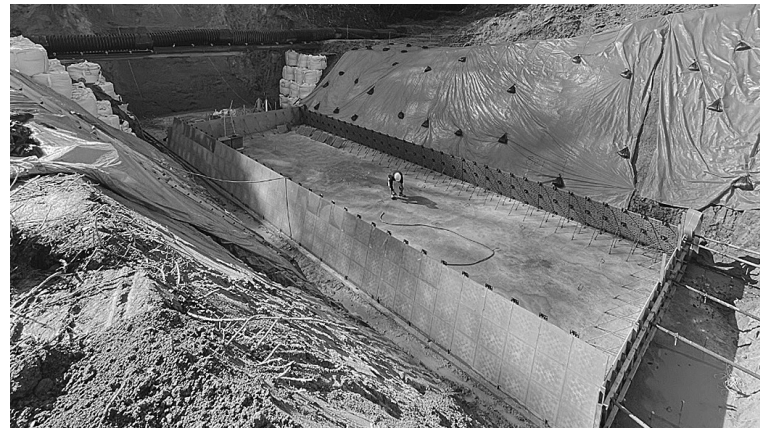
施工：井前建設株式会社 代表取締役 井前 克也 桜井市初瀬4573-1 TEL 0744-47-7388
