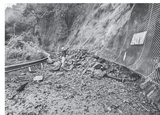
土砂崩れの現場
