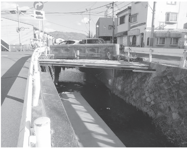
架替が具体化した「恵比須橋」の現況
