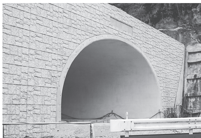
竣工した(仮称)阪本トンネル工事 これから照明など内部設備の整備が本格化する
