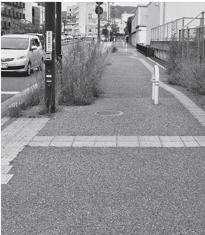
砂利化が進む現行の舗装 (大森町付近)
