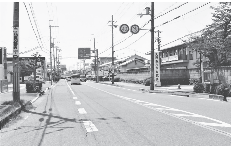
傷みが目立つ醍醐西交差点東側の路面
