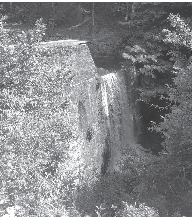
コンクリートの劣化が見て取れる砂防堰堤
