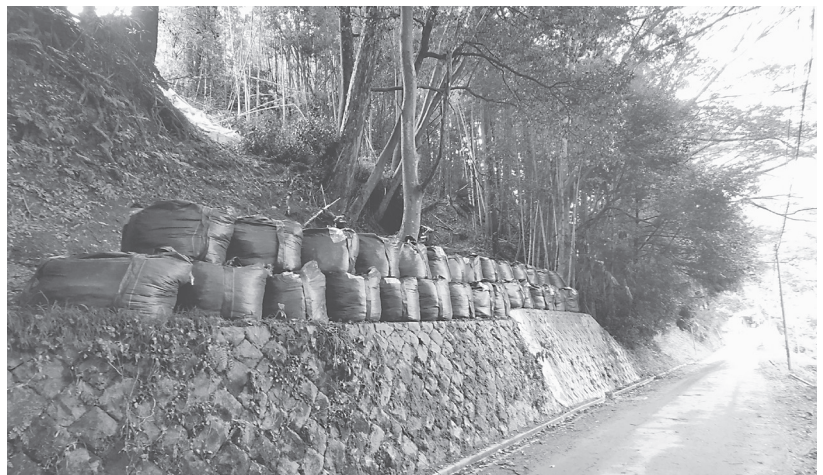
土砂が取り除かれた応急処置後(9月20日撮影)
