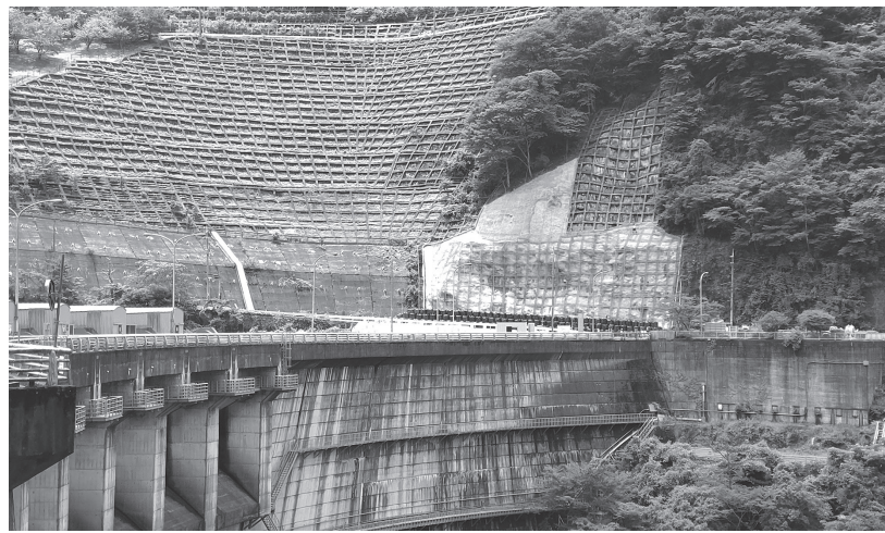
大迫ダムの直近で崩土が発生した(7月20日撮影)
