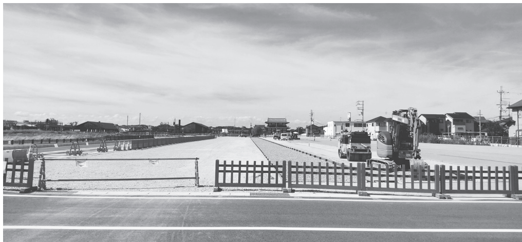
水路(遺構側溝)など、朱雀門広場に連なる形で整備される
